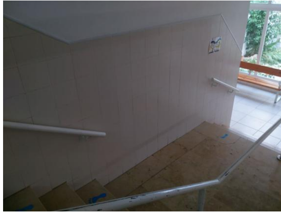
[Fotografia 19]. Zona de les escales que falta un tram de barana.
