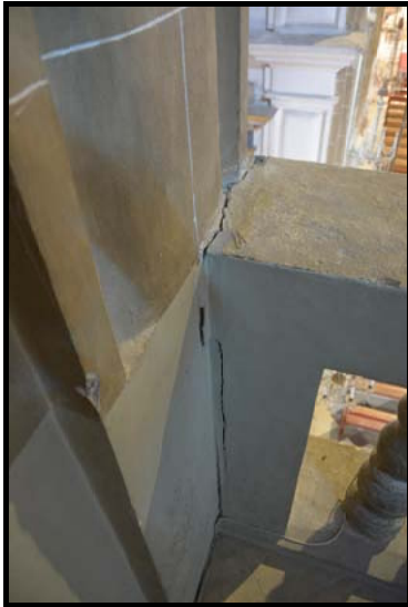
Fig. 98 – Detall de l'esquerda travessant la balustrada.
