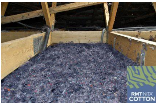
Aïllament de cotó en coberta (Imatge: rmt-nita.es)
