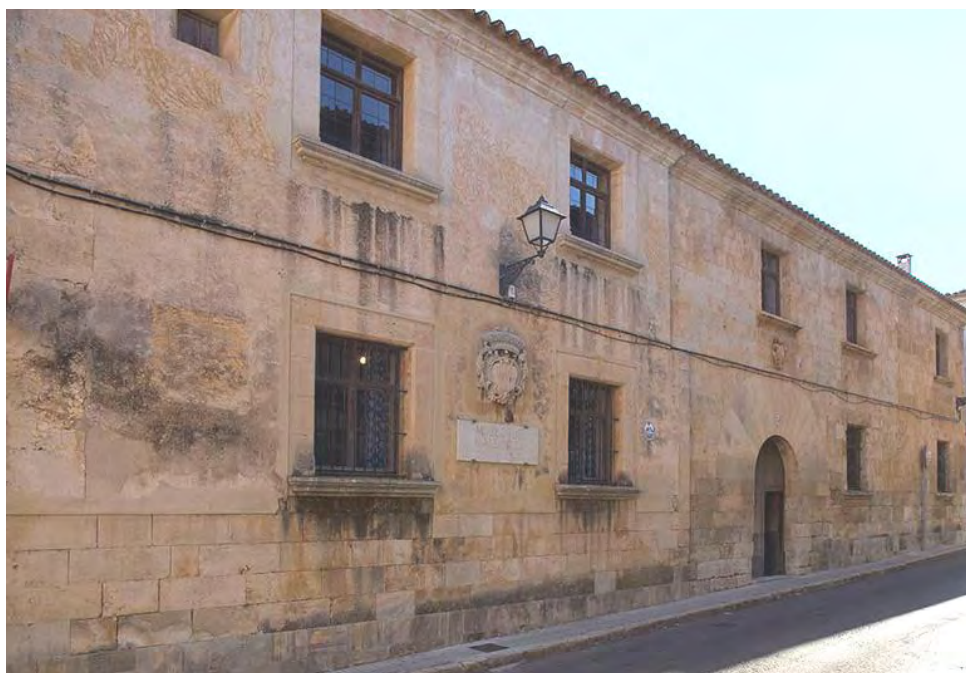
(2) Fotografia d'elaboració pròpia. Estat de la façana de l'edifici-museu del carrer Major.
