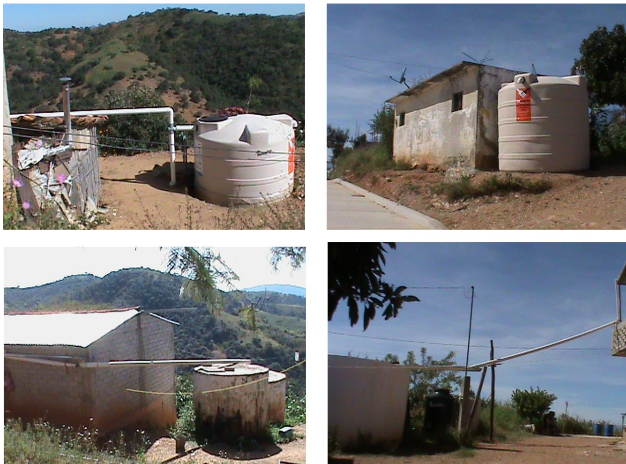
Figura 43. Captación de agua (Fuente: Elaboración propia)
