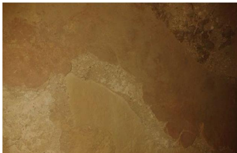
Fig. 188.- Restos del antiguo " trespol " entre la cubierta y la bóveda de la Iglesia de Muro
