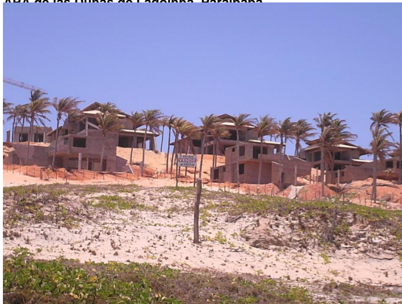
Figura 55 - Complejo Turístico Lagoinha Suítes Resort en el APA de las Dunas de Lagoinha, Barreirinhas
