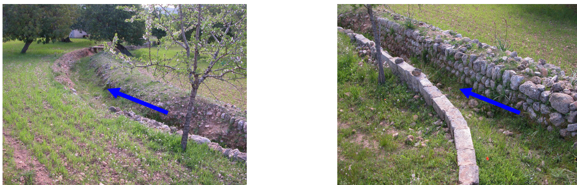
Figura 65: Canalitzacions al torrent de Son Penyaflor de Dalt
