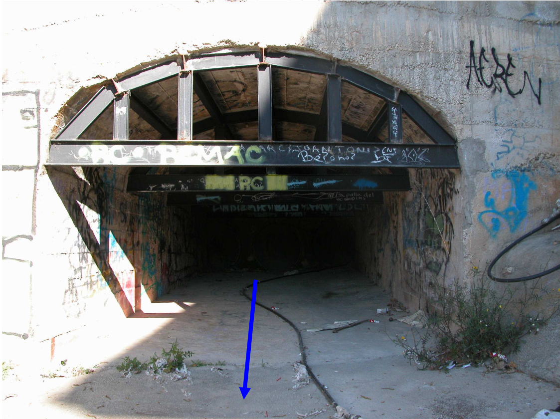
Figura 61: Canalització de sortida del torrent soterrat d'Alaró
