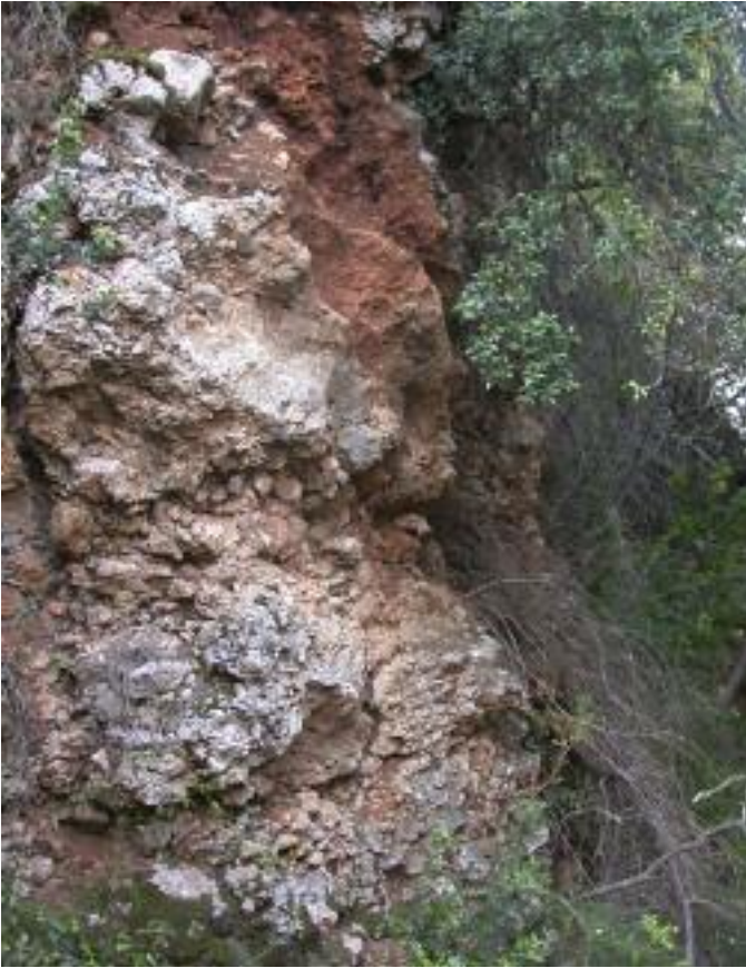
Figura 6. Escarpe de una de las grietas que afectan a las brechas cementadas del Pleistoceno superior, situadas ligeramente al sur de la coronación de la ladera inestable, y que constituyen una zona preferencial de infiltración.
