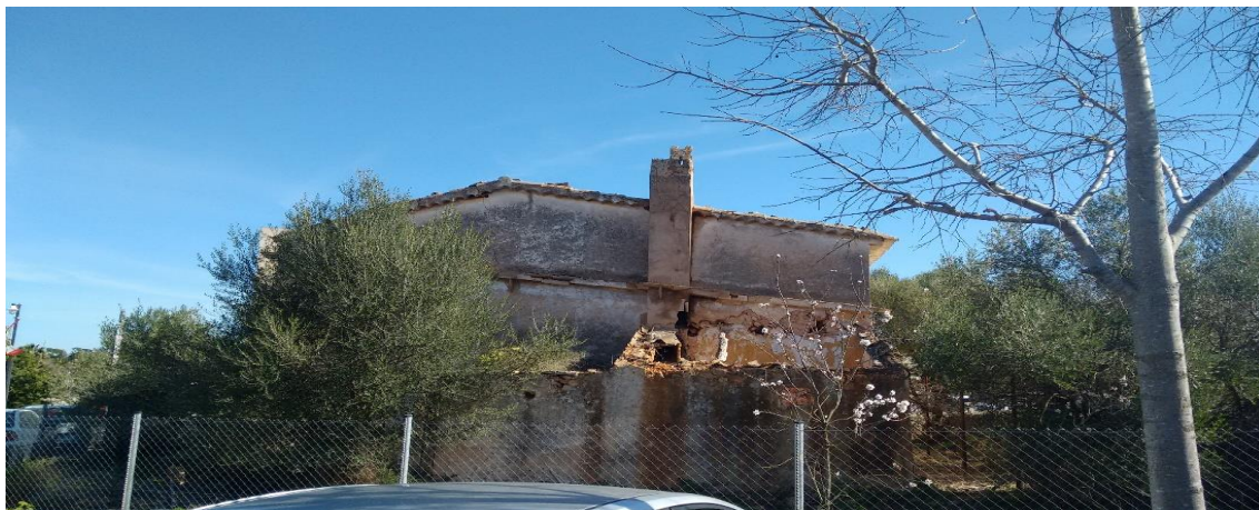
Imagen 8. Ca Ses Llúcies 3 Se pueden observar desprendimientos en cubiertas
