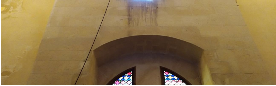
Ilustración 22: Marcas bóveda antiguo coro sobre fachada principal.
