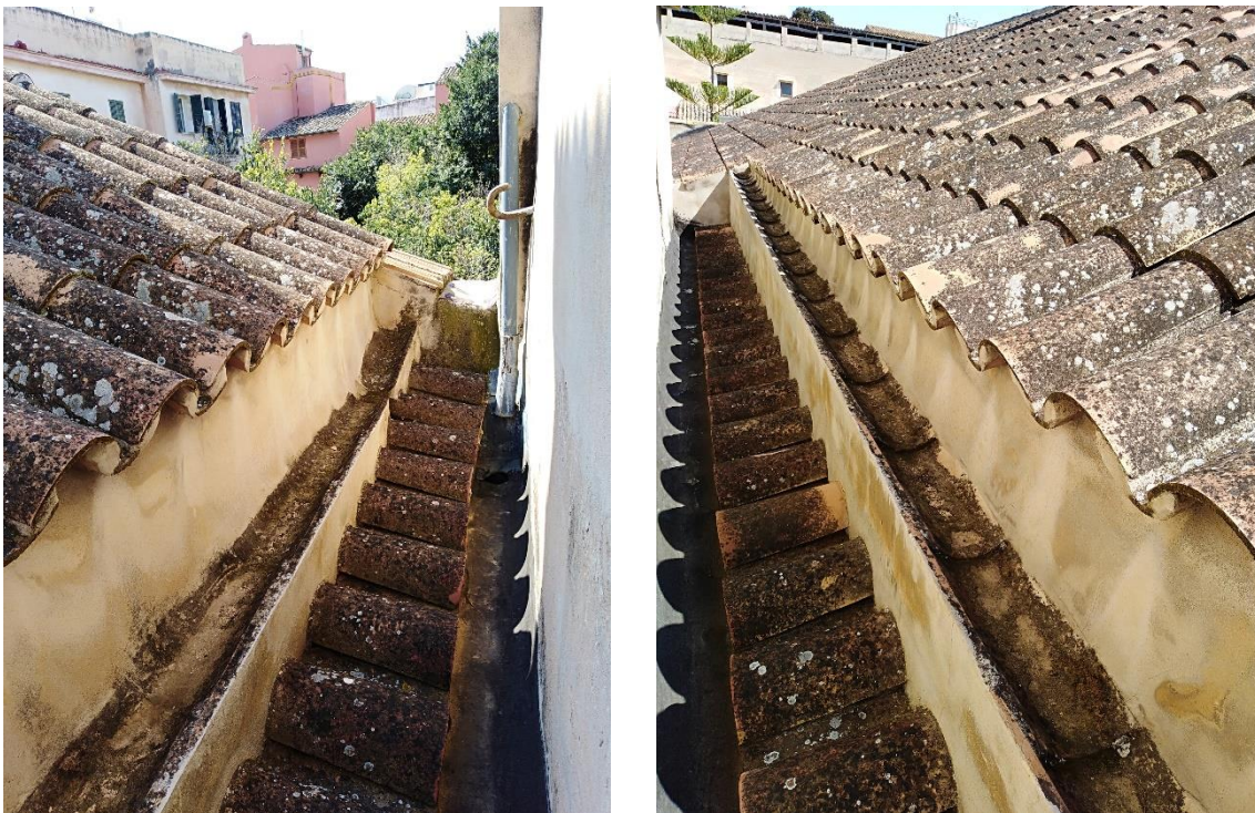
Ilustración 29: Canalón de obra interior.
