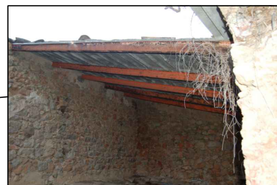
1.1. ELEMENT A RETIRAR: COBERTA DE BIGUETES DE FERRO
