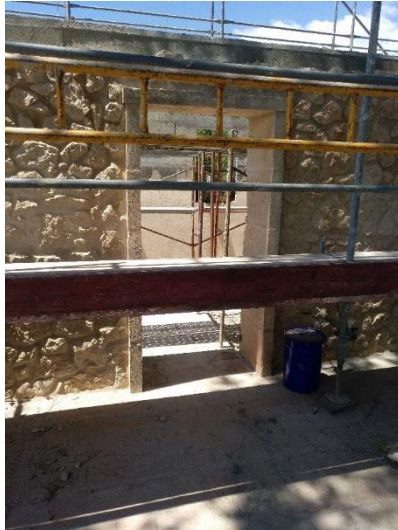
4 – Detalle interferencia entre acceso al interior de la planta piso con andamio perimetral.
