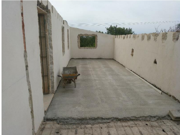
2 – Vista de la planta piso con la capa de refuerzo del forjado de techo de la planta baja.
