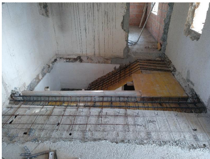
Vista del hueco de escalera sin ninguna protección.
