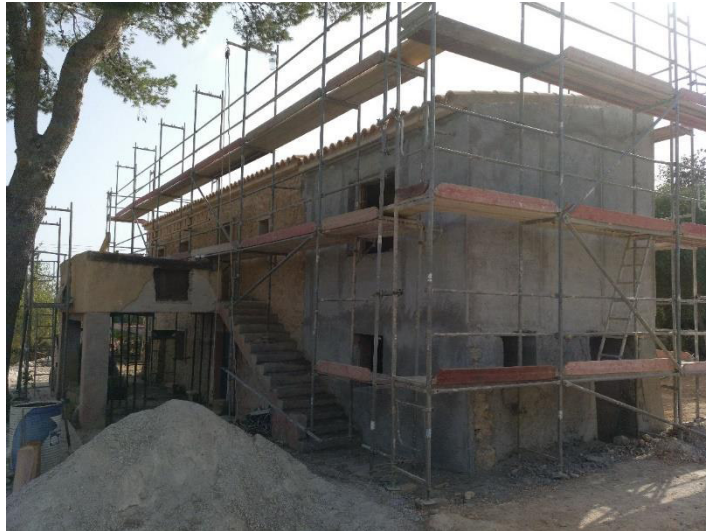
3 – Vista del Edificio Principal (Fachadas Noreste y Sureste) junto con el andamio perimetral.
