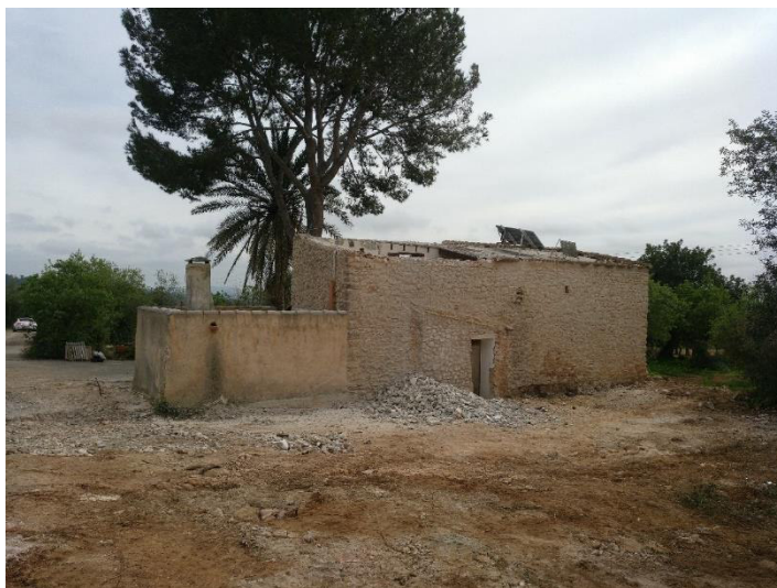
1 – Vista general del Edificio Principal (Fachadas Noroeste y Noreste) con los escombros correspondientes al cuerpo posterior de la planta baja.
