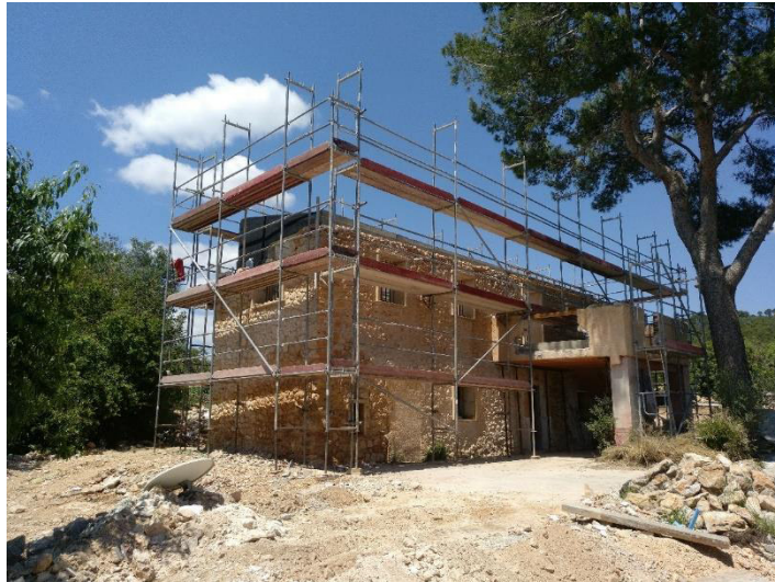
2 – Vista general del Edificio Principal (Fachadas Suroeste y Sureste) junto con el andamio perimetral.
