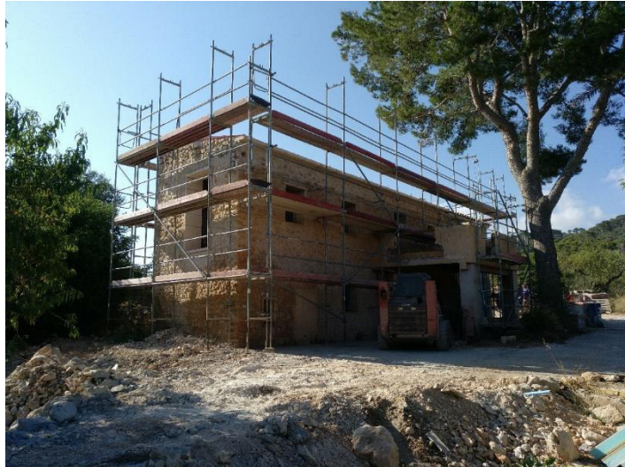
2 – Vista general del Edificio Principal (Fachadas Suroeste y Sureste) junto con el andamio perimetral.
