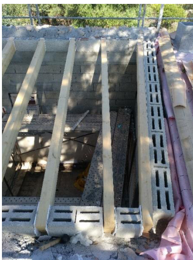
Vista de las plataformas perforadas de acero galvanizado que unen dos andamios tradicionales.
