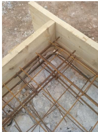
1 – Detalle del encuentro entre el armado del zuncho de borde y el armado de la viga, con los suplementos en L atados a las barras longitudinales con alambre.
