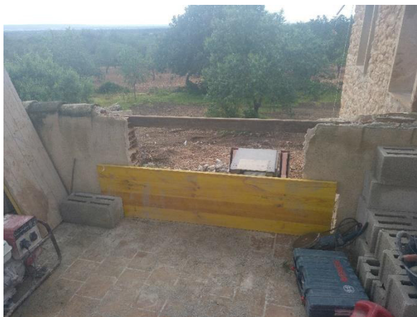
Hueco realizado en el antepecho de fábrica en la terraza de acceso a la planta piso. Acopio de fábricas en las proximidades del hueco.
