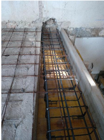
3 – Detalle del armado de la viga de borde en el forjado de techo de la planta baja.
