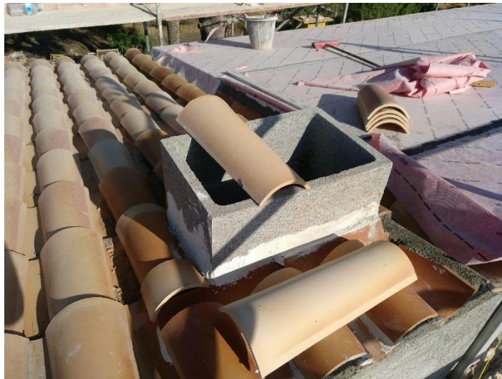
3 – Detalle del remate de la cubierta de teja con la salida de humos.
