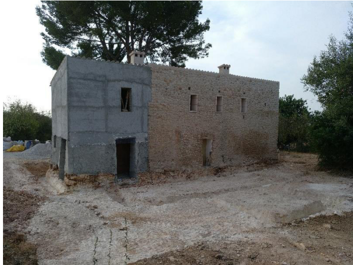
1 – Vista general del Edificio Principal (Fachadas Noroeste y Noreste) y el vaciado realizado en la zona posterior.
