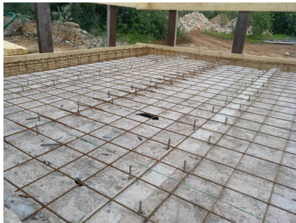
2 – Detalle de los conectores y el mallazo en la zona de la terraza lateral de la planta piso. Faltan por colocar los separadores bajo el mallazo.
