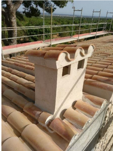
5 – Detalle encuentro cobertura de teja con chimenea en zona de ampliación de planta piso.
