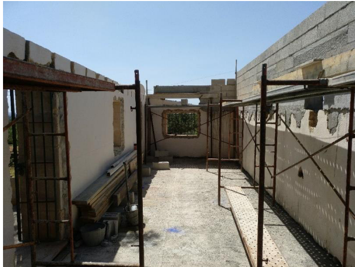
5 – Vista de la planta piso con la disposición de los andamios tradicionales.
