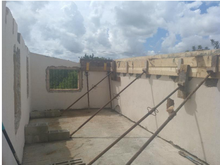
2 – Vista de la planta piso con el encofrado del zuncho de apoyo del nuevo muro de carga.
