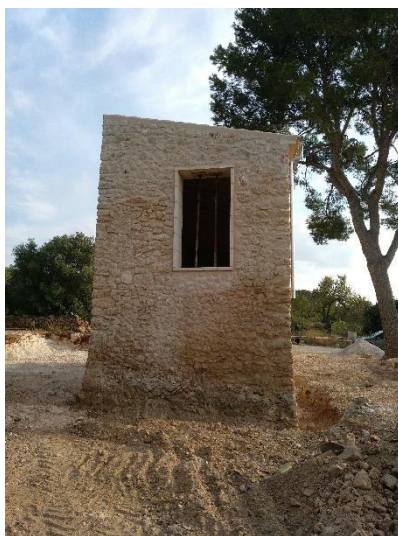
Vista de la fachada Suroeste con la balconera y los puntales situados en su interior.
