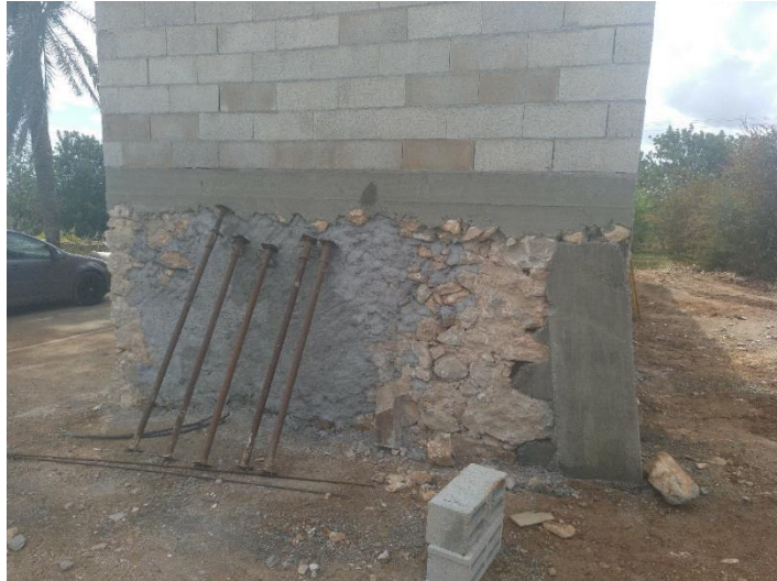
4 – Detalle del refuerzo de la esquina entre las Fachadas Noroeste y Noreste, y relleno de las juntas entre las piedras del muro de carga de mampostería.
