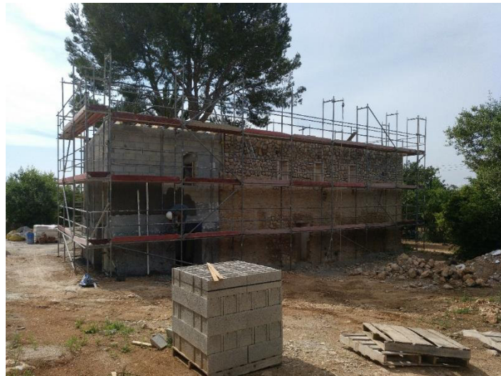
1 – Vista general del Edificio Principal (Fachadas Noroeste y Noreste) junto con el andamio perimetral.
