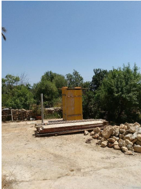
Caseta realizada con tableros que hará la función de inodoro de los trabajadores, con el inodoro en su interior conectado a la fosa séptica existente.
