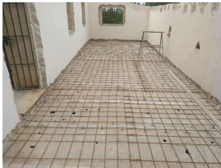
5 – Armado de refuerzo en la zona de planta piso. Faltan por colocar los separadores bajo el mallazo.
