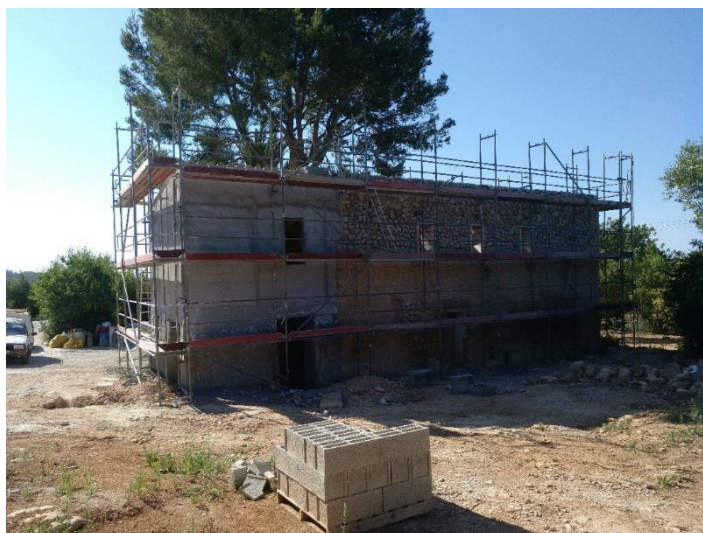
1 – Vista general del Edificio Principal (Fachadas Noroeste y Noreste) junto con el andamio perimetral.
