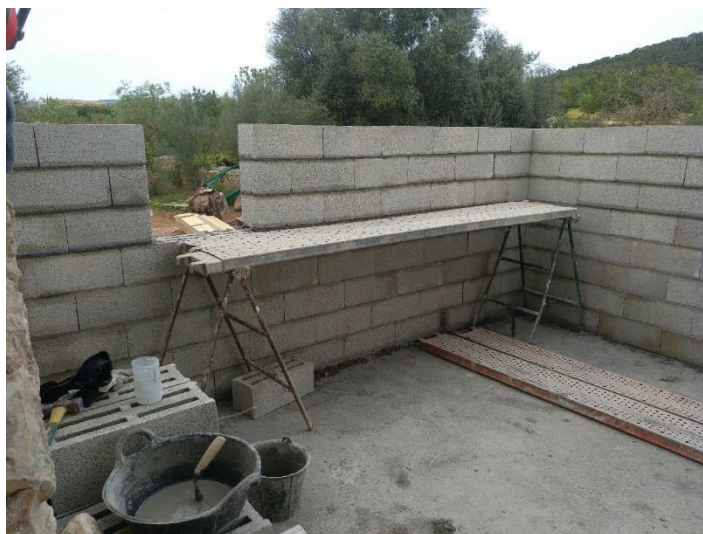
Detalle de la plataforma sobre borriquetas junto al hueco de fachada. Se observa que la protección frente al riesgo de caída en altura es de 60 cm, insuficiente e inexistente en la zona del hueco.
