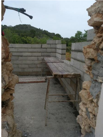
Detalle de la plataforma sobre borriquetas junto al hueco de fachada. Se observa que la protección frente al riesgo de caída en altura es de 60 cm, insuficiente e inexistente en la zona del hueco.
