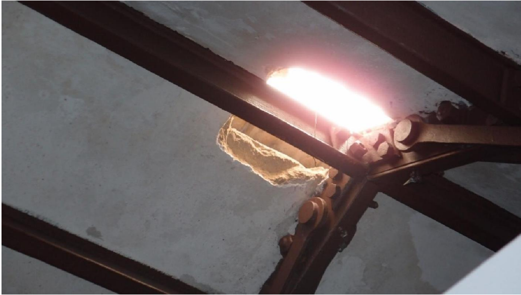
Imagen 1.4.13: Hueco en cubierta existente. Se desconoce el origen del mismo.
