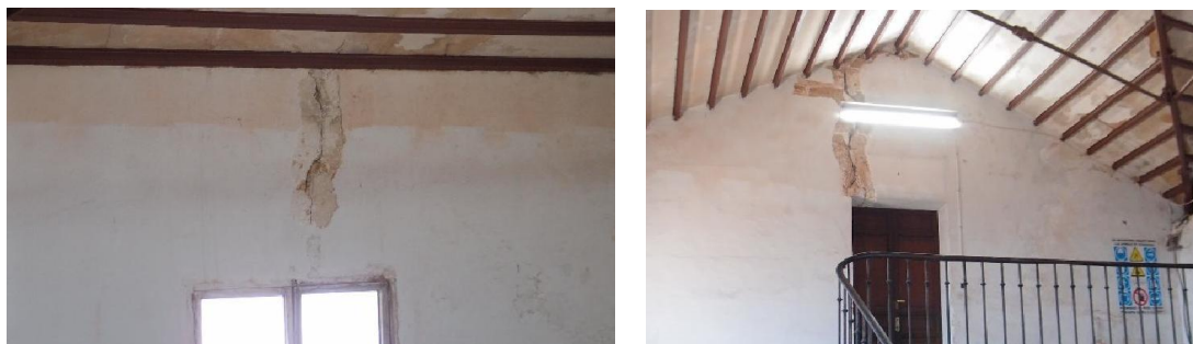
Imágenes 1.4.21 y 1.4.22: Grietas en muros, acrecentadas por catas realizadas con anterioridad.
