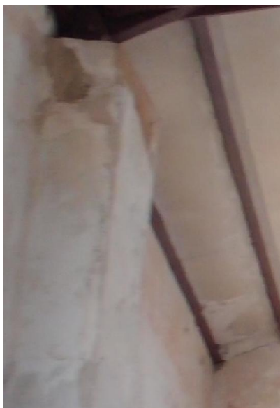
Imagen 1.4.25: Desprendimientos en algunas pilastras en la parte superior de las mismas, donde se anclan los pernos de la estructura de las cerchas que soportan la cubierta del edificio.
