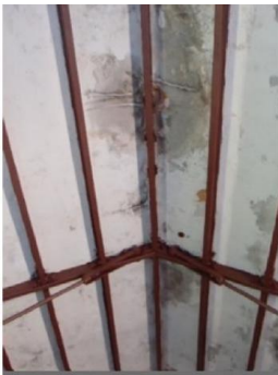
Imagen 1.4.7: Humedades y filtraciones en cubierta.
