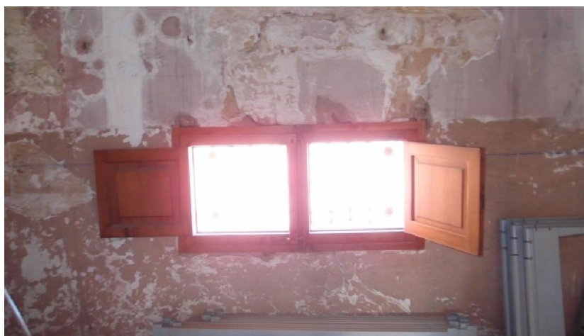
Imagen 1.4.30: Humedades en los muros de fachada.
