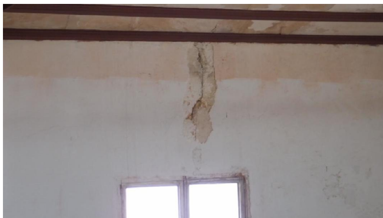
Imagen 1.4.29: Grietas en los muros de fachada de marés.
