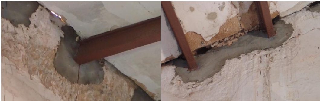
Imagen 2.2.10: Puente térmico en encuentro Muros Transversales y Cubierta.
