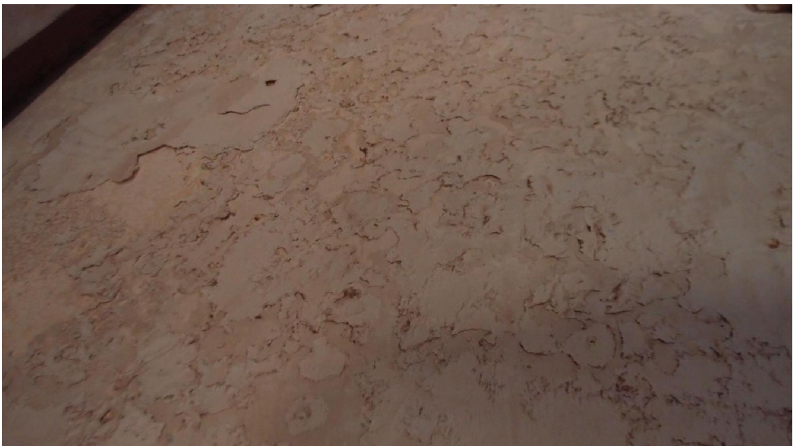
Imagen 1.4.32: Acabado de los paramentos verticales con desconchones.
