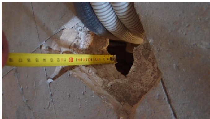
Imagen 1.4.15: Hueco de paso de instalaciones pertenecientes a la instalación del ascensor en el interior del almacén. Espesor del hueco de 10 cm.
