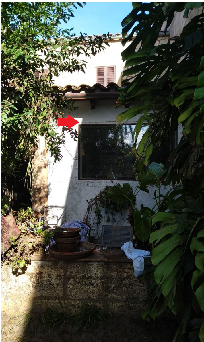
Figura 18. Imatge d'una casa afectada on es pot apreciar el nivell que va assolir l'aigua. Font: Elaboració pròpia.
