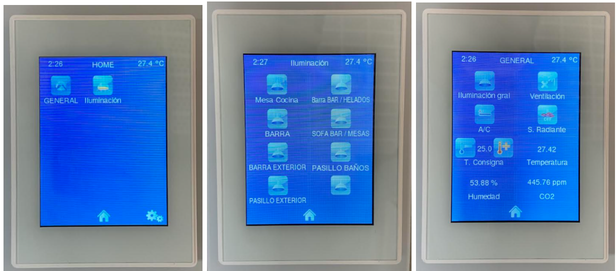
(a) Pantalla Z41 - Vista General (b) Pantalla Z41 - Control Iluminación (c) Pantalla Z41 - Control General
