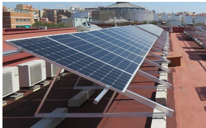
Fig. 2. Generador didáctico del Solar Academy Lab. Fuente: Amara NZero
