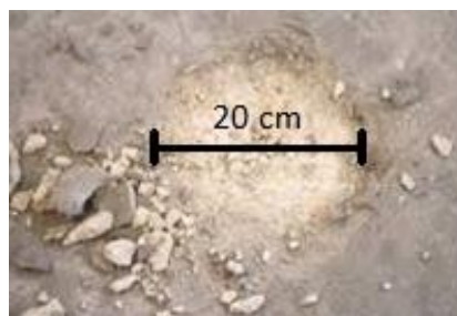
Figura 6 Zona de hormigón dañada
