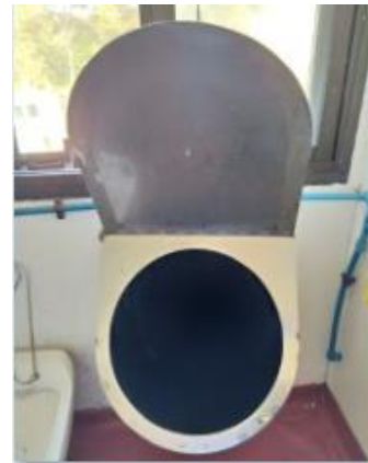
Figura 29: Entrada bolsas ubicado en cuarto basuras
