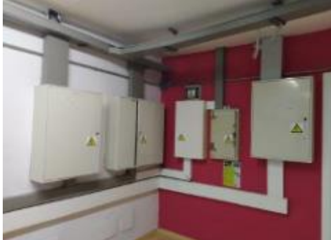
Figura 11: Cuadros eléctricos área cocina
