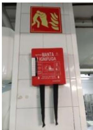
Figura 10: Manta ignífuga en cocina (fogones)
