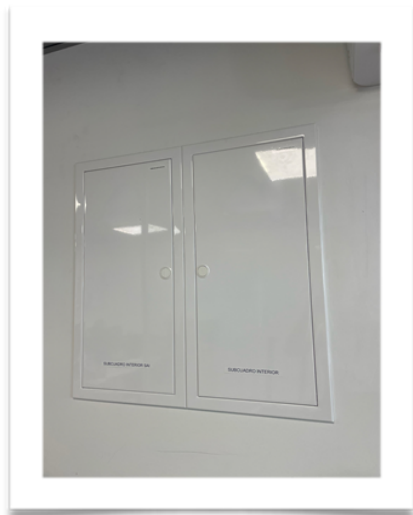
Ilustración 2: Cuadro eléctrico sin señalizar
