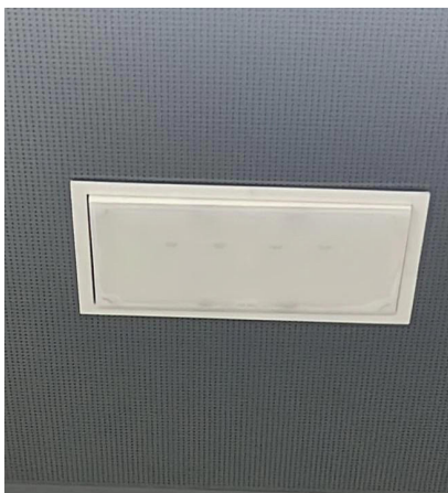
Ilustración 5: Fallo de luz de emergencia
