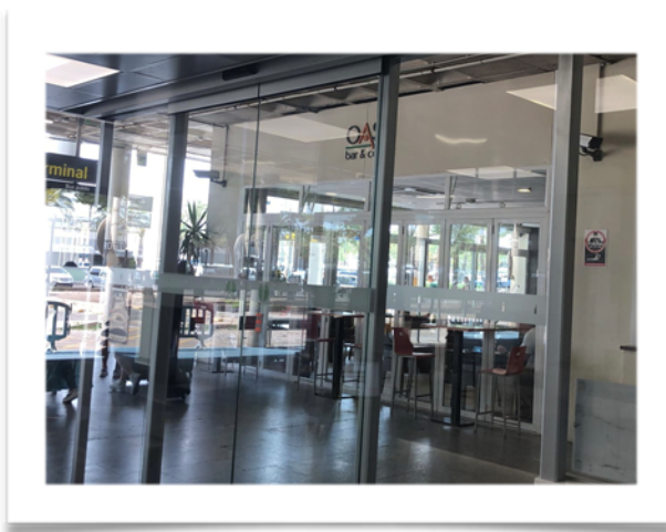
Ilustración 4: Falta de señalización de salida de
